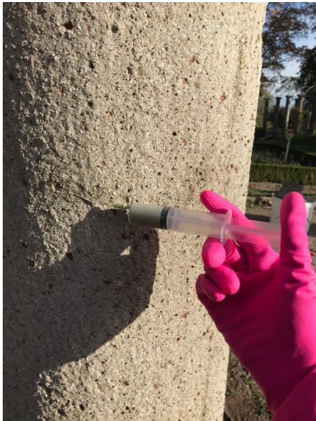
Karlsgarten, Stuttgart, Kunststeinsäule, Rissverfüllung
